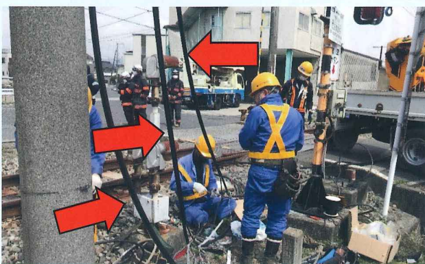
パトカーや消防車も出動していて現場は騒然・・・！ ケーブルは見事に切断されていました。
