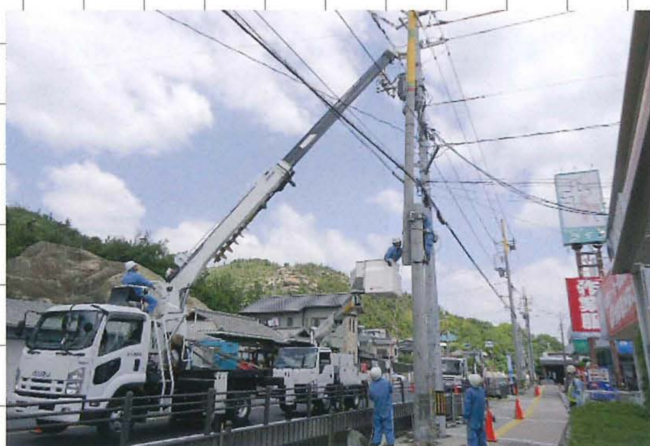
電柱撤去 (高圧線の中で倒せないで切断して撤去している所です)
